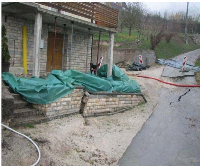
Slika 11: Primer posedanja temelja zaradi plazenja
