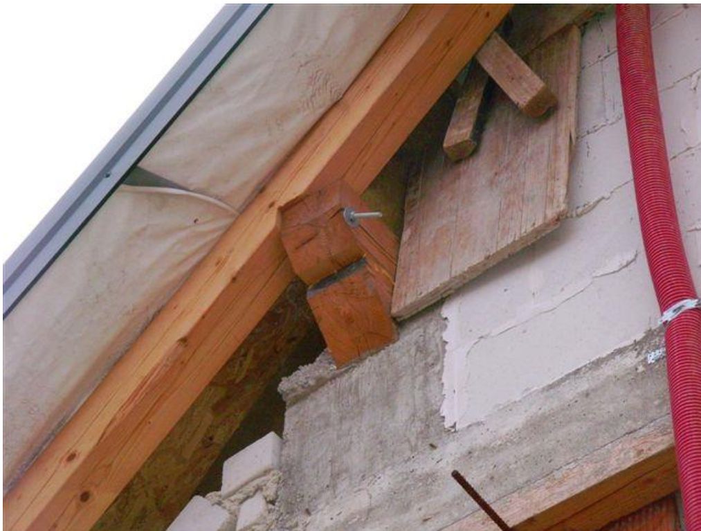
Slika 32: Nepravilno sidrane lege
