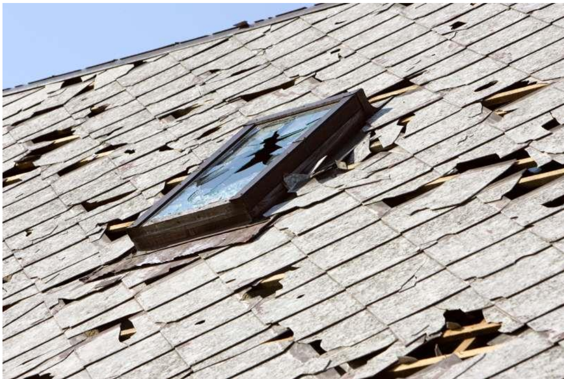
Slika 29: Poškodba strehe zaradi toče
