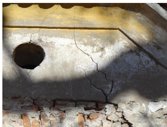
Slika 4: Primer razpok zaradi posedanja temeljev do strehe (graščina Radvanje)
