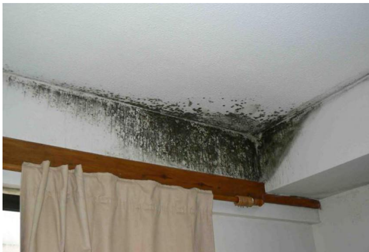
Slika 28: Vlažen zid zaradi vdora vode
