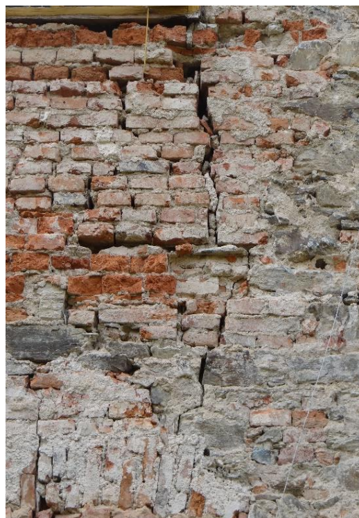
Slika 57: Primer razpoke zidu (graščina Radvanje) (Vir: Lastni vir ( 31.10.2020 ))
