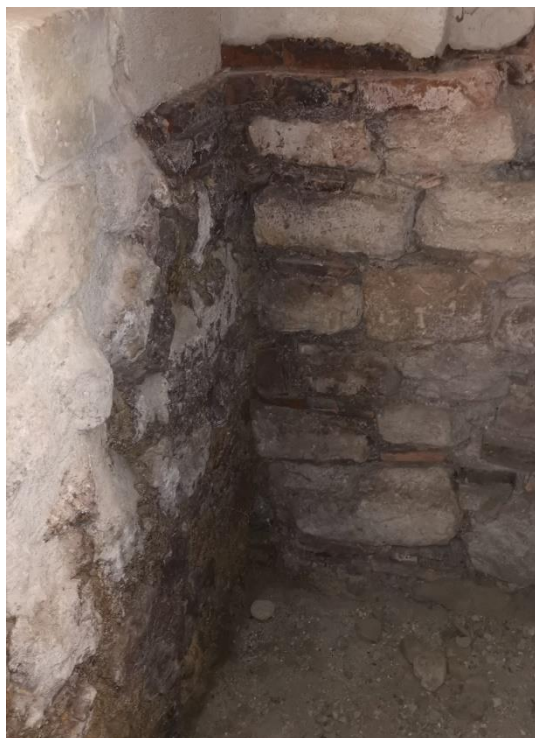
Slika 20: Stari zid brez hidroizolacije
