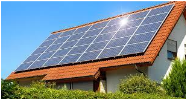
Slika 4.3: Fotovoltaika – samooskrba z električno energijo
