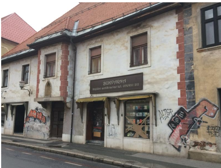
Slika 2: Primer vandalizma na Koroški cesti (lasten vir)
