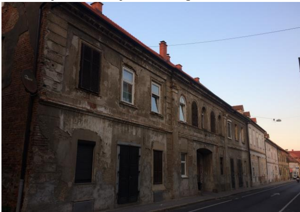
Slika 1: Koroška cesta in njeno stanje (lasten vir)
