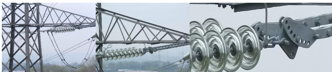
Slika 11, vir: Thermal drone Ltd
