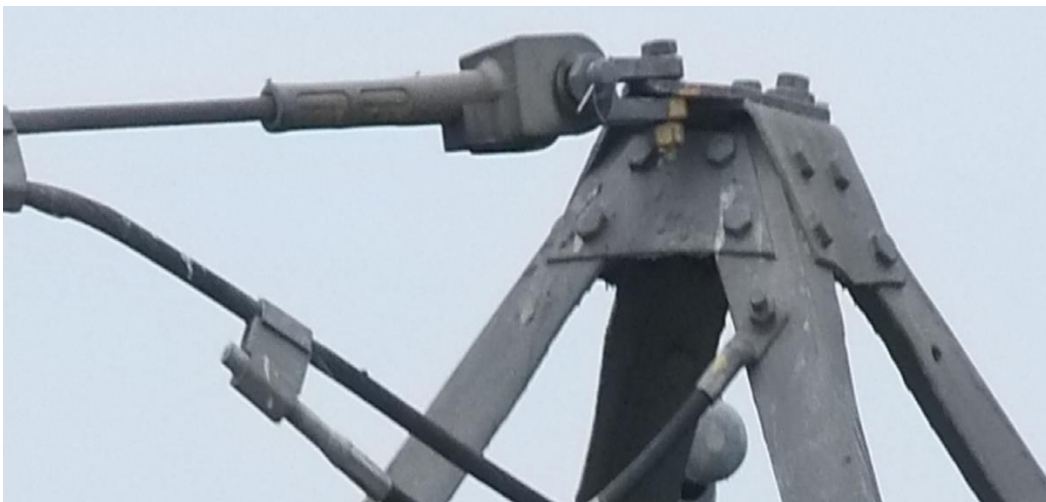
Slika 12, vir: Thermal drone Ltd
