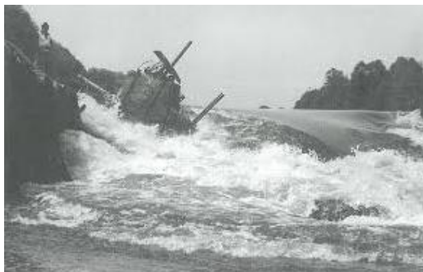
Slika 42: Porušen jez na Muri.
