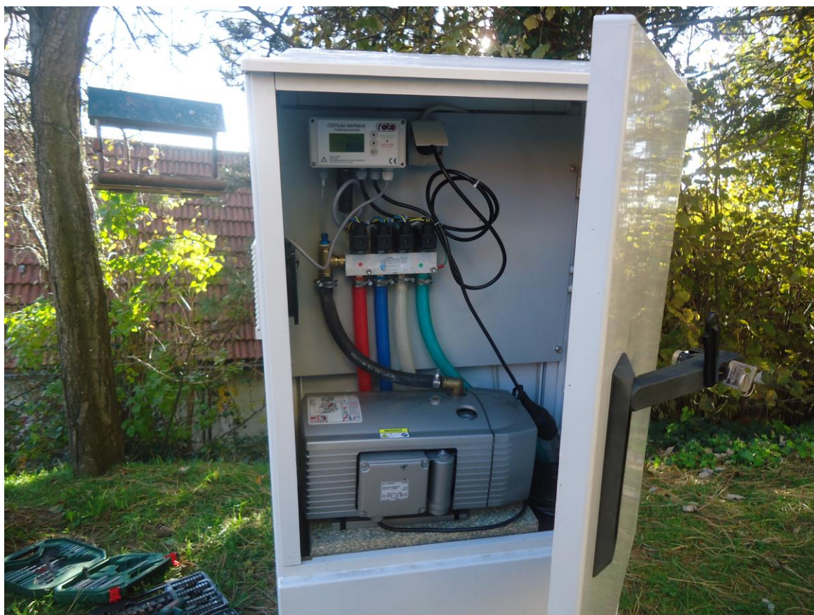
Slika 6 Prikaz kompresorja in ventilov pri mali čistilni napravi v omarici
