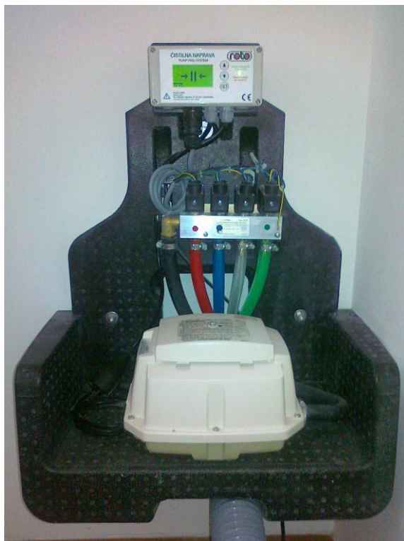
Slika 7. Prikaz kompresorja in ventilov pri mali čistilni napravi v objektu
